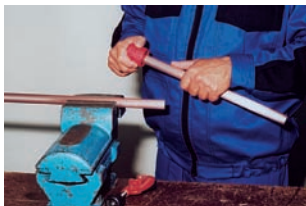
б) очистити від задирок зовнішній і внутрішній бік труби (або відкалібрувати її);
